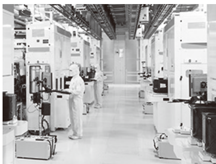
クリーンルーム
